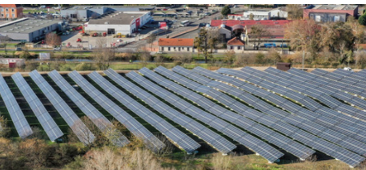
Parc solaire de Montretout - Vue du drone
